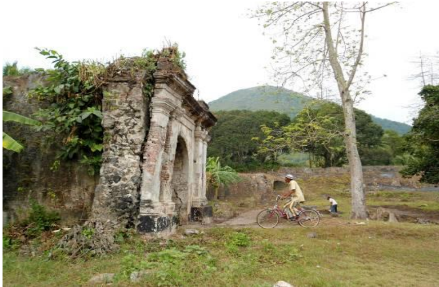
Foto 2: Bentuk kerusakan pada struktur pintu gerbang sisi selatan Benteng Nassau yang miring dan retak.
