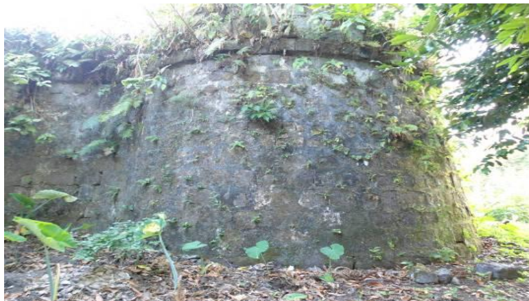
Foto 3: Bastion Nassau sisi tenggara yang masih utuh namun banyak ditumbuhi pohon yang membuat retak-retak dan terkelupasnya kulit-kulit batu dan pkest dan terkelupasnya kulit-kulit batu.
